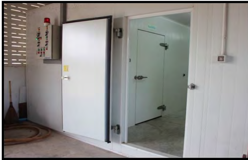
ภาพที่ 6-48 ห้องเย็นสำหรับพักโซลาร์ใหม่ เก็บโซลาร์ใหม่ และห้องปรับสภาพโซลาร์ใหม่
