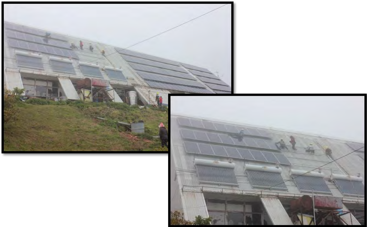
ภาพที่ 6-37 การดำเนินการก่อสร้างติดตั้งแผงเซลล์แสงอาทิตย์ในช่วงที่มีหมอกหนา
