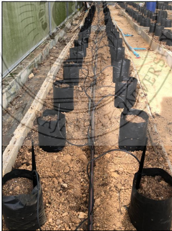
ภาพที่ ง- 21 การติดตั้งแนวท่อระบบน้ำสำหรับแปลงสาธิตเมล่อน
